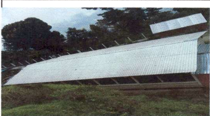
Foto 1: La lamina del techo de la escuela se encuentra deteriorada por lo que se pretende cambiar para evitar la filtración de agua de lluvia. Medidas: 21mts. Largo por 11.5 de ancho equivalente a 42 laminas en
