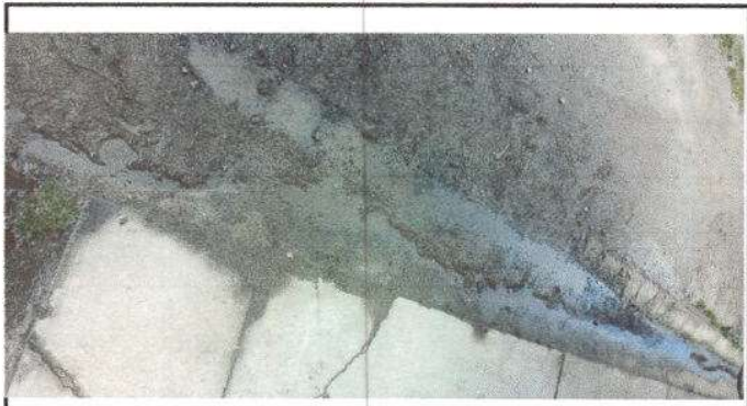
Foto 4: Cuneta para drenar el agua ya que el agua se enpila por las fuertes lluvias. Cantidad 36 metros.
