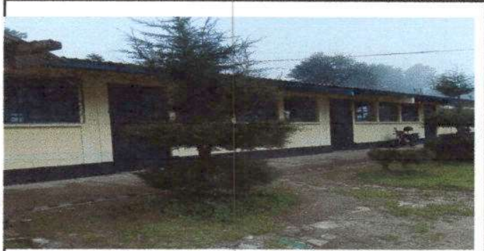
Foto 2: Pintura del edificio escolar de 5 modulos, ya que se encuentra deteriorada. Equivalente a 318 mts.
